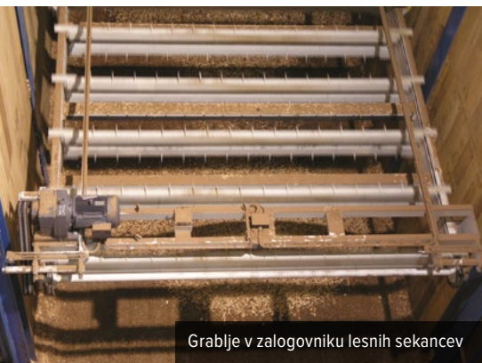
Dogorevalna rešetka pod kotlom 3
