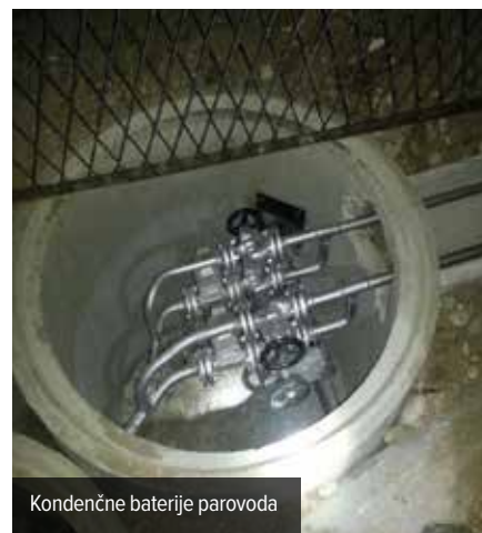
Dreniranje na by-passih kondenznih baterij parovoda
